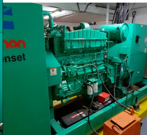
Panorámica planta eléctrica
