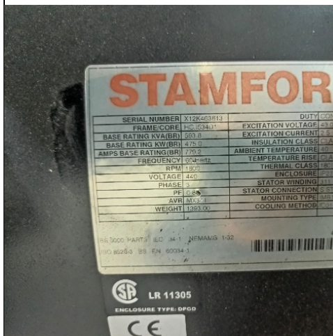
Placa de generador
