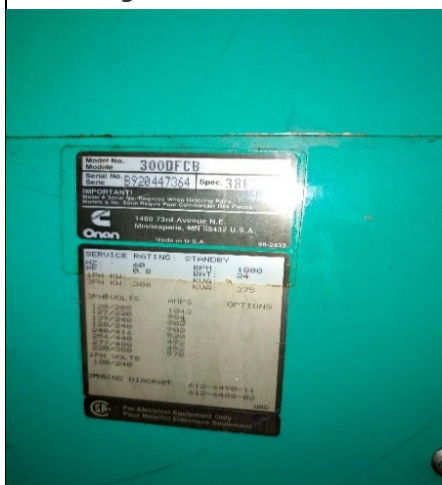
Placa de generador
