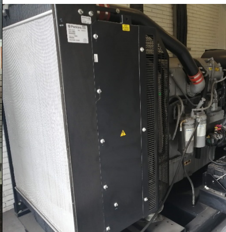
Panorámica planta eléctrica
