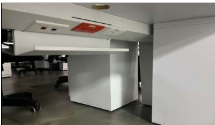
Ilustración 2. - Detalle del cableado estructurado en los puestos o escritorios.
