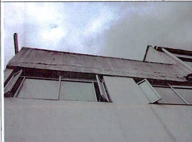
Foto 11. Grieta en la junta entre antepecho y entrepiso.
