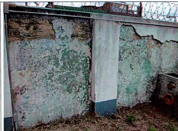
Foto 52. Desprendimiento de acabados del cerramiento.
