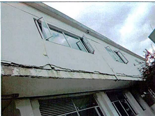
Foto 4. Desprendimiento de acabados de placa en fachada.
