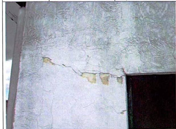
Foto 37. Agrietamiento en muro del tercer piso.
