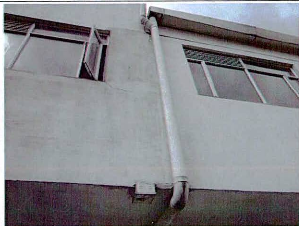
Foto 12. Fisuras y grietas en el segundo piso de la fachada.
