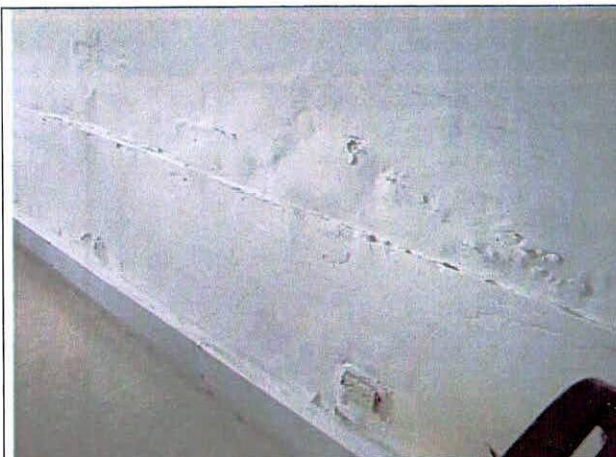
Foto 21. Deterioro de acabados de muros por humedad.
