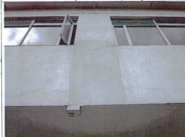
Foto 13. Grietas en la fachada del costado oriental.
