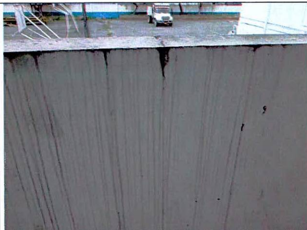
Foto 34. Fisuras y deterioro en antepecho, segundo piso.
