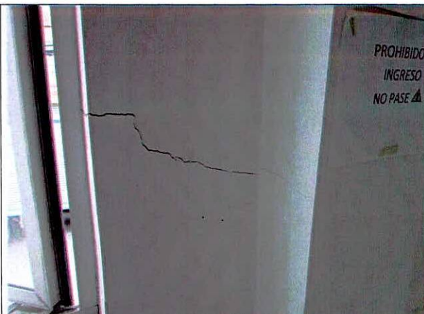
Foto 28. Agrietamiento en muro del segundo piso.
