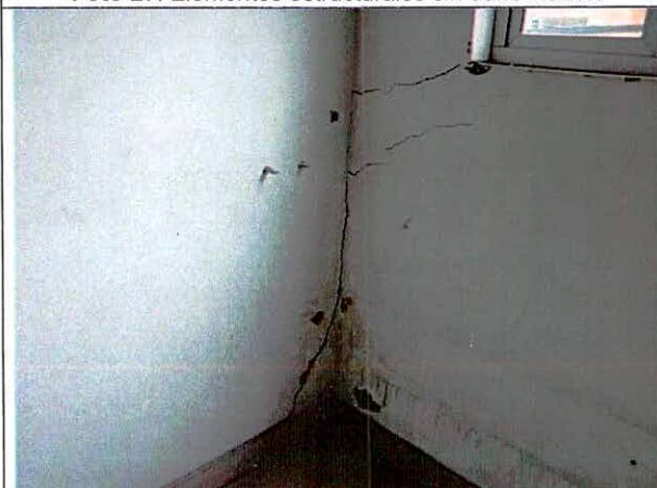
Foto 29. Agrietamiento costado oriental del segundo piso.
