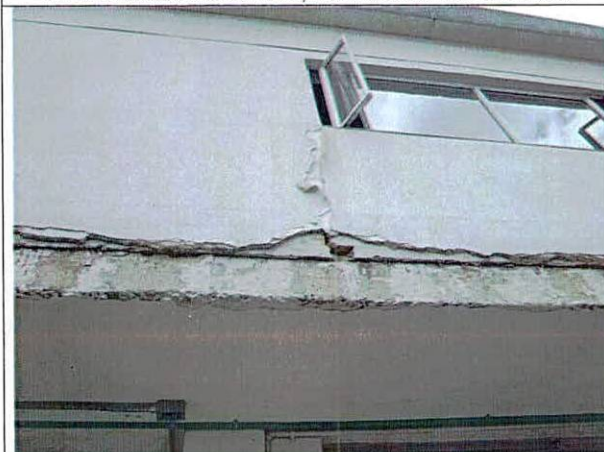
Foto 5. Deterioro de los acabados del entrepiso, fachada.
