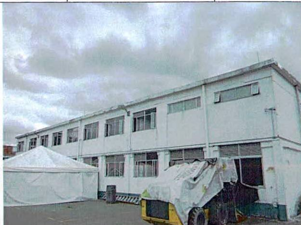
Foto 6. Fachada interna, deterioro de acabados.
