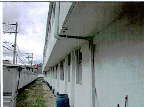
Foto 3. Muros de fachada, buen estado con deterioro.
