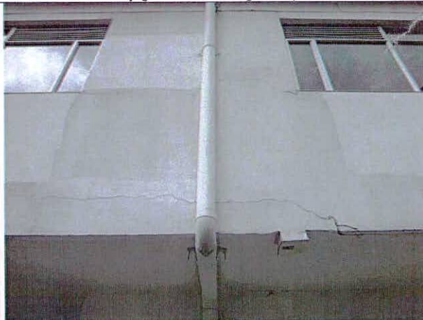
Foto 14. Fisuras y agrietamientos en fachada oriental.
