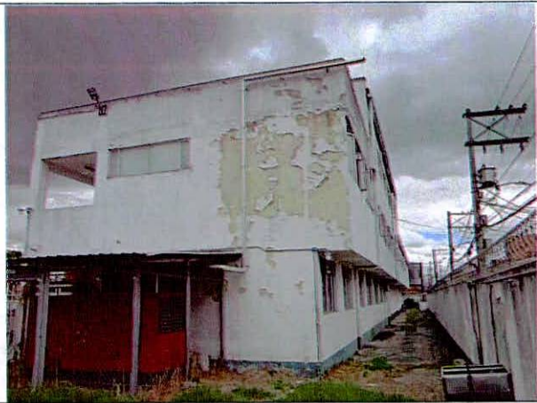
Foto 10. Deterioro fuerte de los acabados de la fachada.
