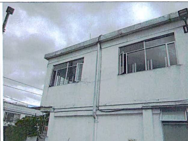
Foto 8. Fisuras y deterioro en muros de la fachada interna.
