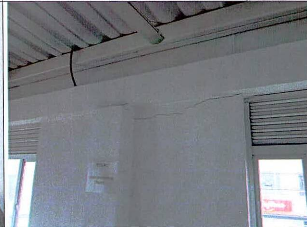
Foto 32. Grieta horizontal, muro del segundo nivel.
