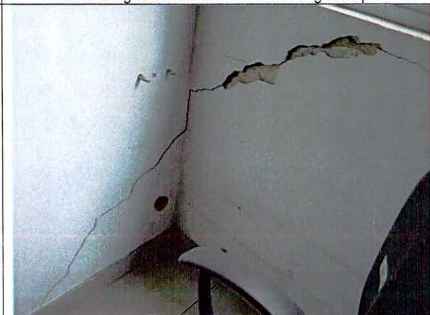
Foto 30. Fracturas, daño fuerte de muro de segundo piso.
