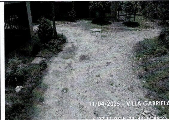
Ilustración 16. Desgaste de Subrasante Tramo 4
