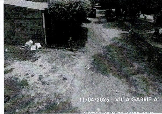
Ilustración 2. Desgaste de Subrasante Tramo 1.
