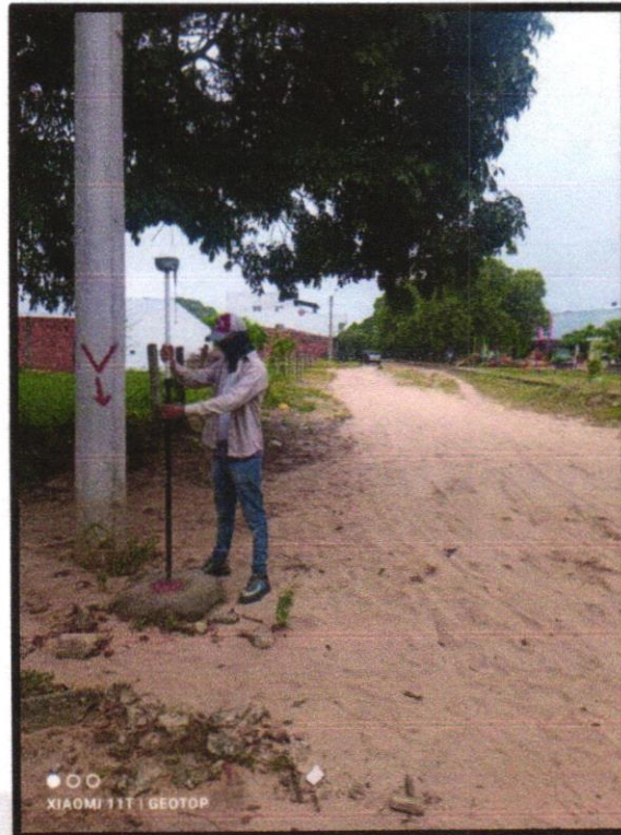
TOMA DE PUNTOS VALVULAS
