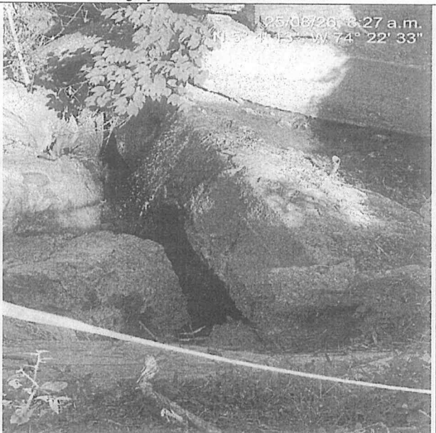
Fotografía 4. Socavación del Ponton.
