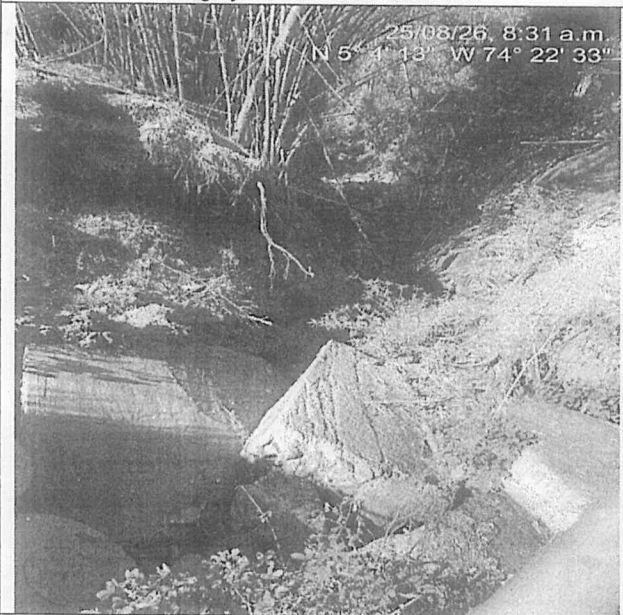
Fotografía 5. Escombros del Ponton.
