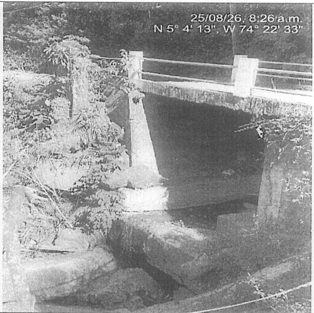
Fotografía 2. Deterioro del Ponton.
