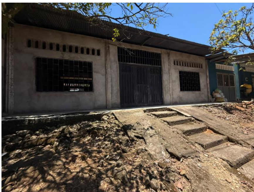
Figura 5. Deterioro en placa del andén y gradas de acceso al salón - Fuente Propia Secretaria de Planeación y de las Tic's
