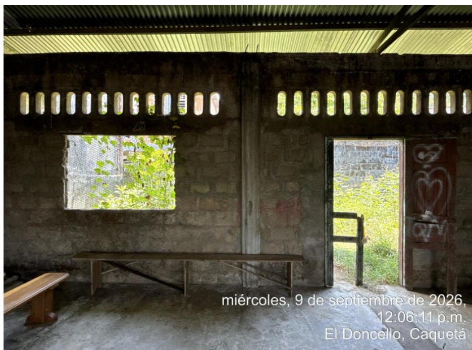
Figura 3. Puerta y ventana faltante en la caseta. – Fuente Propia Secretaria de Planeación y de las Tic's
