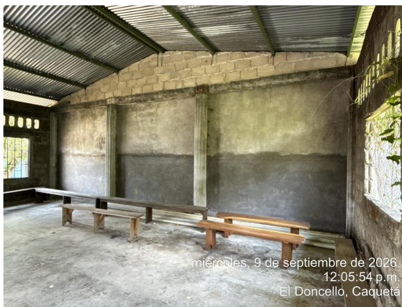
Figura 6. Muro perimetral propio faltante - Fuente Propia Secretaria de Planeación y de las Tic's
