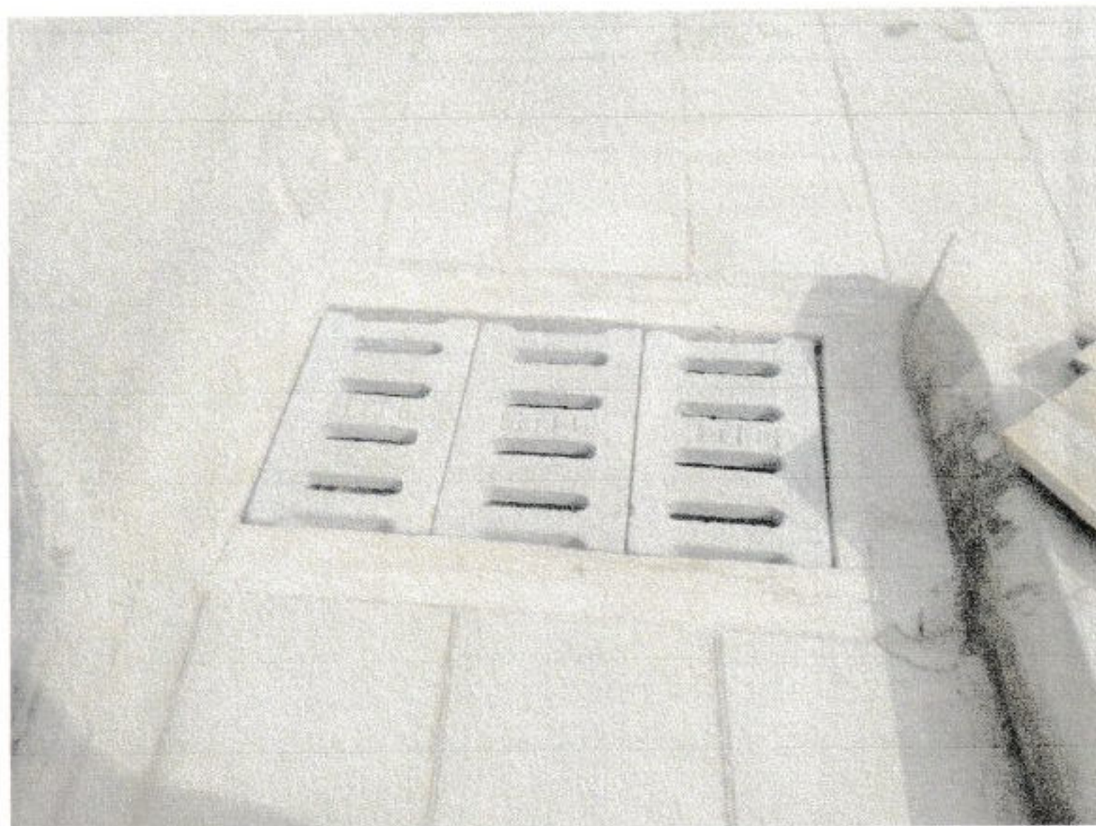
Imagen 17: Evidencia Fotográfica Sumidero – Fuente: Residente de Obra
