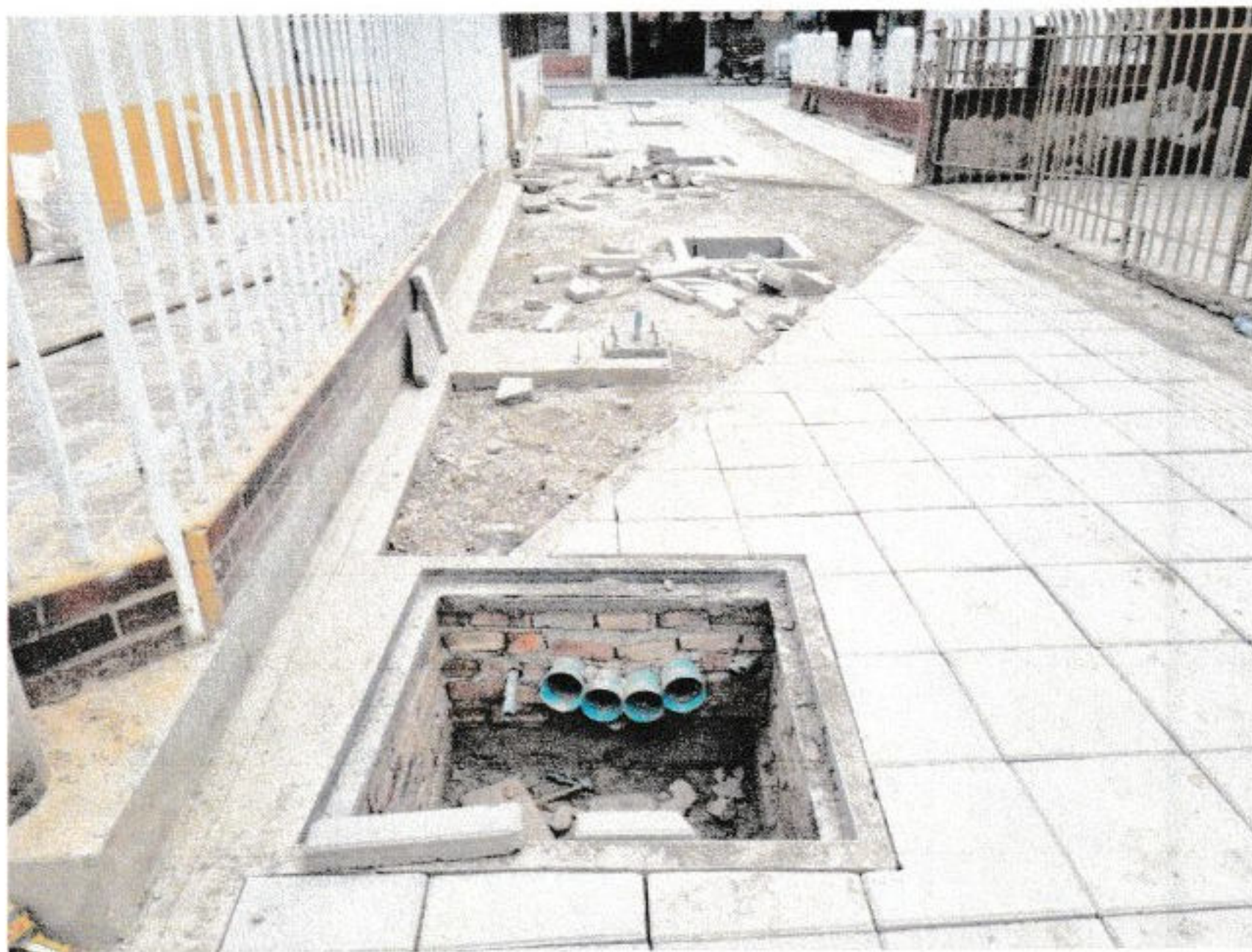
Imagen 22: Evidencia Fotográfica Cajas baja y media tension– Fuente: Residente de Obra
