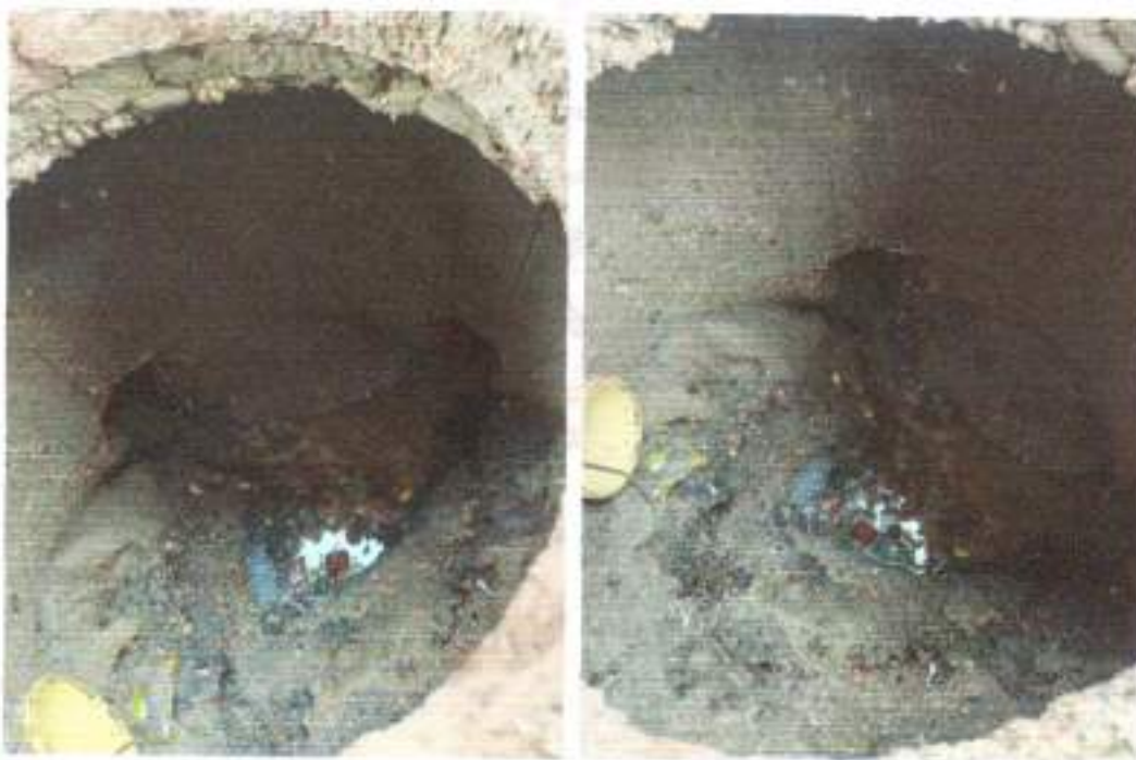
Fotografía 3. Acumulación de aguas servidas y material de arrastre en una de las cajas de inspección existentes. La inspección visual confirma que el sistema no tiene la capacidad de evacuar los sólidos, evidenciando la obstrucción interna de la tubería.
