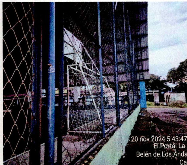
Fotografía 6. Cerramiento perimetral: malla eslabonada y parales metálicos con pintura desgastada y corrosión; muro de borde con pintura deteriorada, decoloración y suciedad acumulada.
