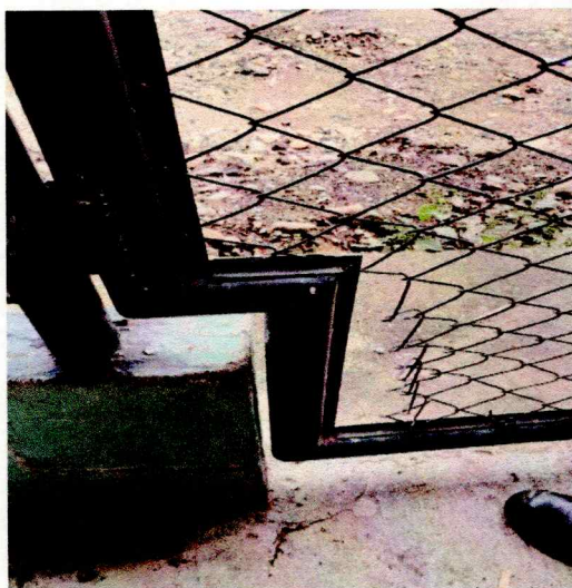
Fotografía 5. Detalle del cerramiento perimetral: perfiles metálicos con pérdida del recubrimiento anticorrosivo, focos de oxidación, malla eslabonada desprendida y pedestal de concreto con pintura deteriorada.
