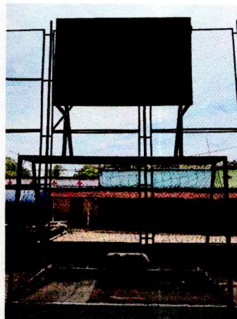
Fotografía 4. Tablero de baloncesto del costado opuesto, sin aro ni demarcación y con estructura de soporte expuesta a la intemperie; arco de microfútbol con malla deteriorada.
