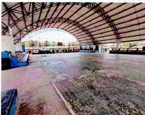
Fotografía 1. Vista general de la placa deportiva: desgaste generalizado y desprendimiento del recubrimiento, zonas de concreto expuesto, pérdida de la demarcación reglamentaria y graderías con pintura deteriorada.
