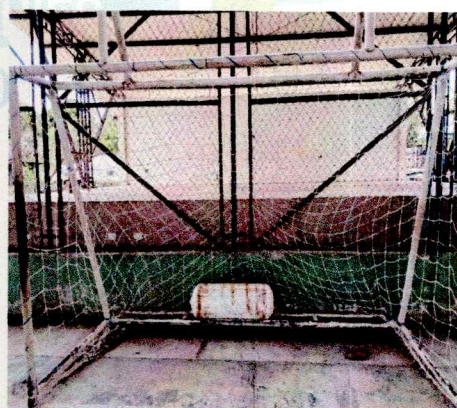
Fotografía 2. Arco de microfútbol: malla deteriorada, rota y destensada; estructura metálica con pérdida del recubrimiento y focos de corrosión en bases y uniones.
