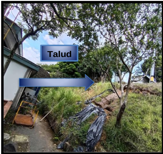
Foto 4: Perfil del talud con la falla.
