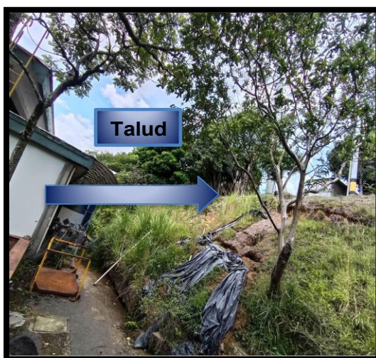
Foto 4: Perfil del talud con la falla.
