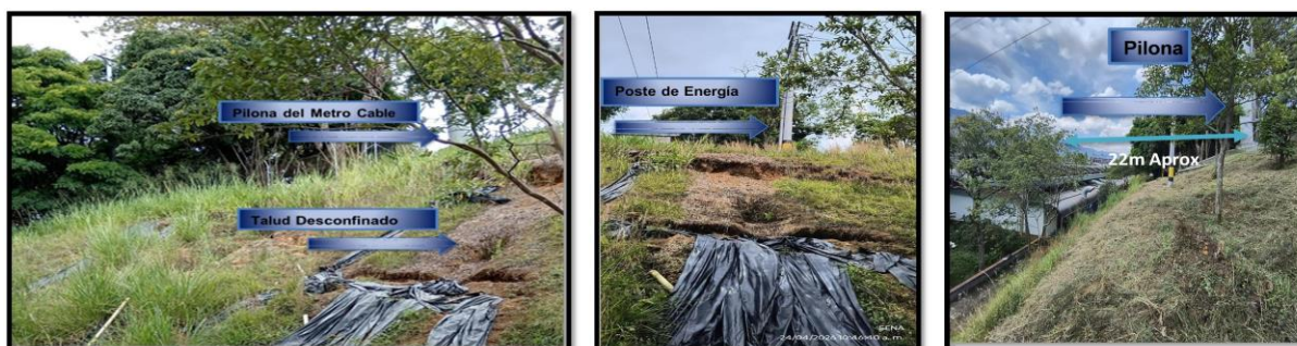
Gráfica 1. Estado del talud: terreno sin soporte lateral cerca de la pylona del Metrocable (izquierda), erosión junto a un poste de energía (centro) y distancia aproximada a la pylona (derecha)
