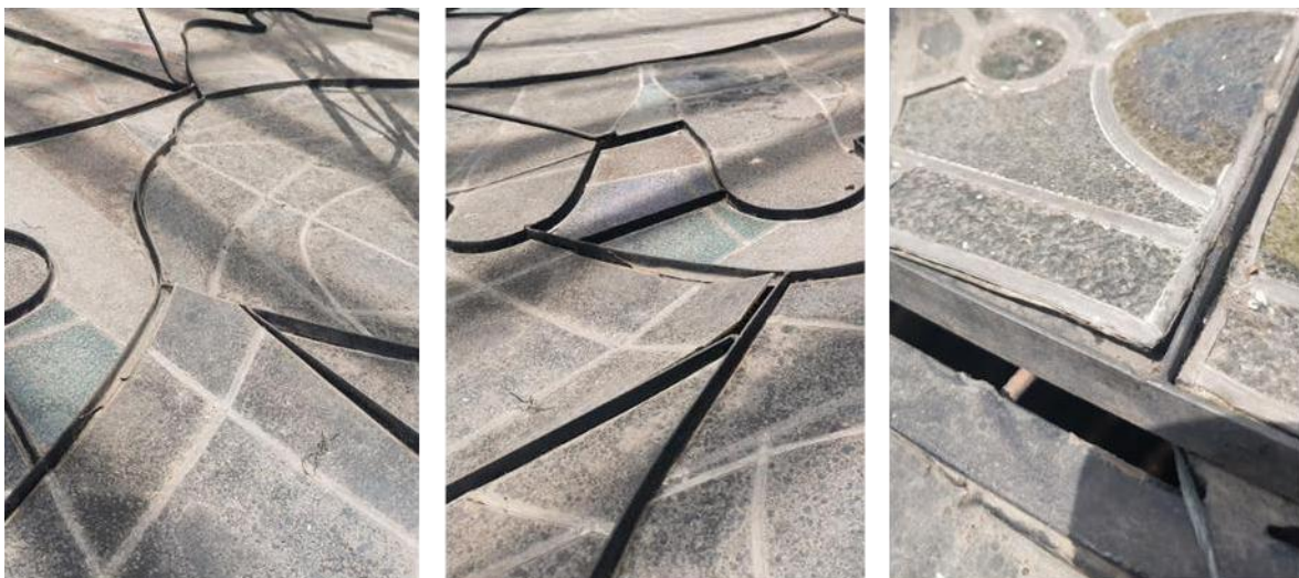
Figura 4. Fotografías que exponen el estado de los paneles que se han ido soltando dentro de los marcos de plomo.
