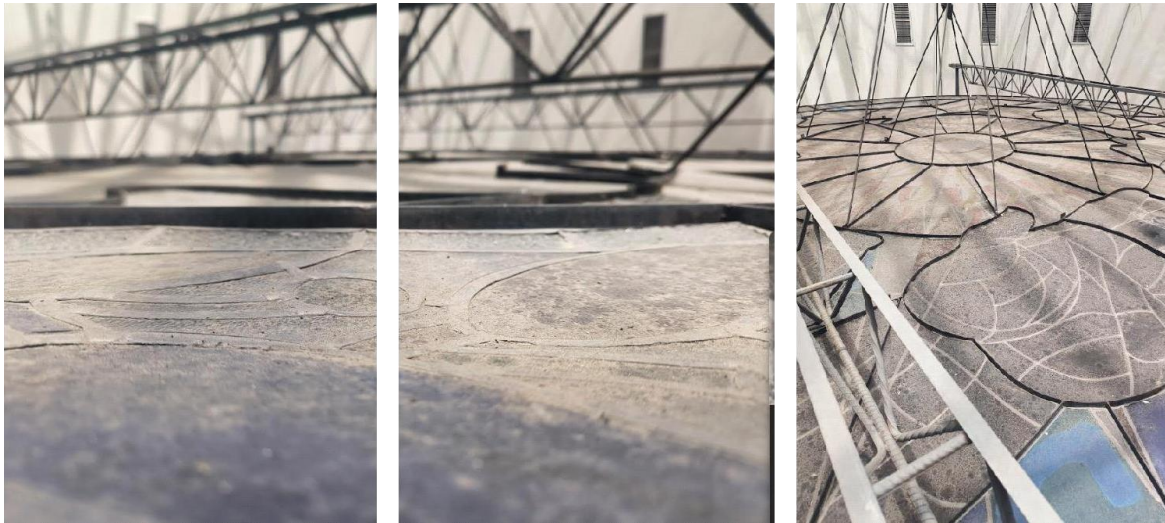
Figura 2. Fotografías que exponen el estado de afectación por el polvo y condiciones ambientales.
