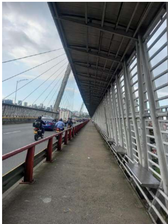
Fotografía No 14: estado de guarda rail, andén, baranda y tirantes viaducto
