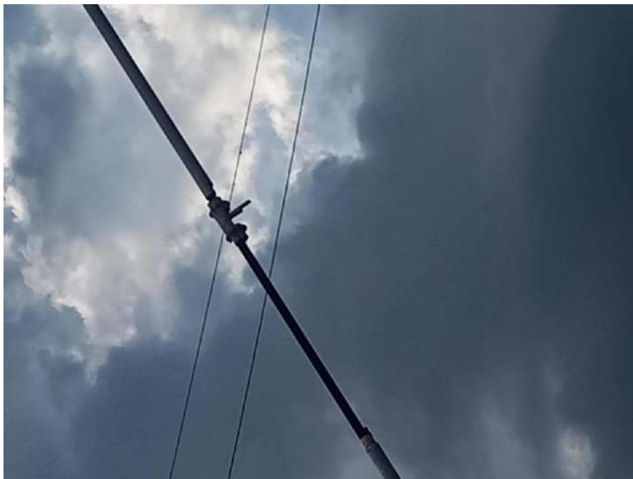
Fotografía No 15: tirante con pérdida de cobertura puntual
