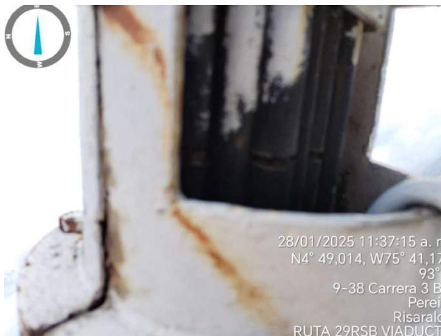
Fotografía No 23: estado de los torones dentro de la cobertura
