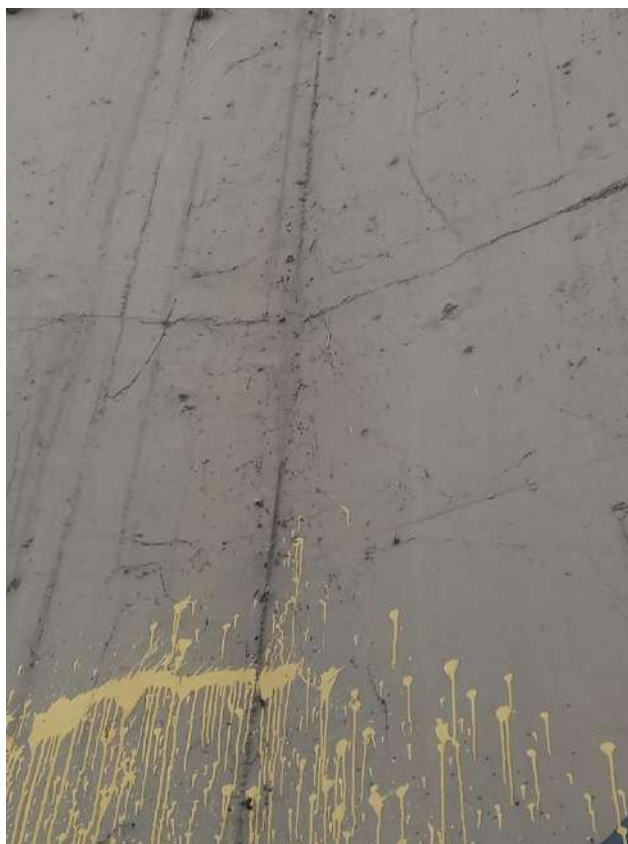
Fotografía No 7: fisuras en pilastra Dosquebradas
