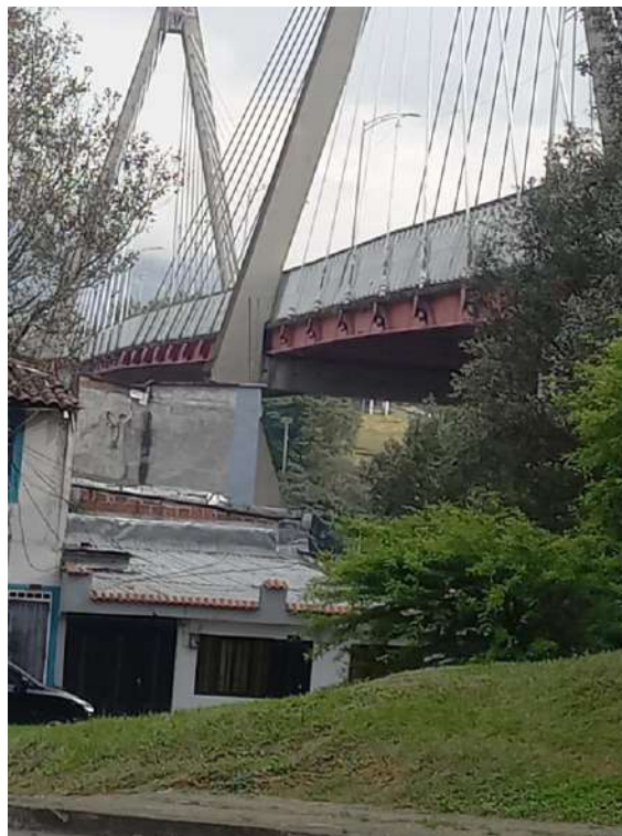
Fotografía No 17: vista lateral viaducto desde Pereira. Se observan contraflechas y leves curvaturas horizontales en planta
