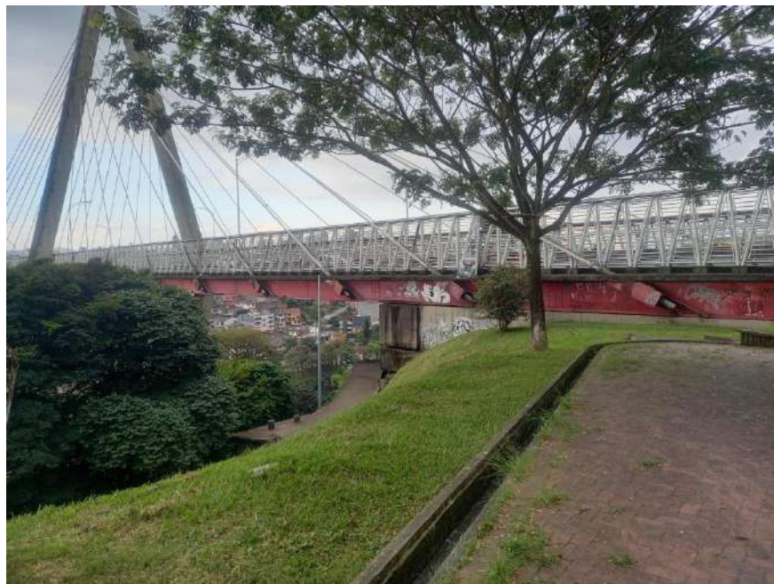
Fotografía No 2: vista lateral del estado de vigas y anclajes de cables
