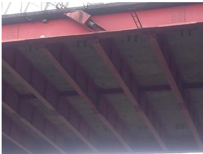
Fotografía No 3: detalle lateral del estado de vigas y anclajes de cables
