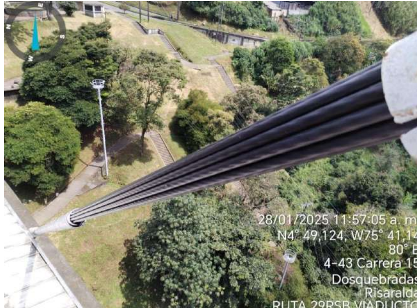
Fotografía No 24: estado de los torones tipo tirante en sector sin cobertura
