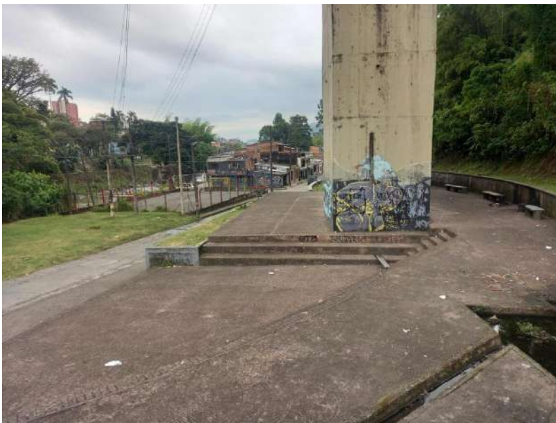
Fotografía No 6: estado de la base de la pilastra Dosquebradas
