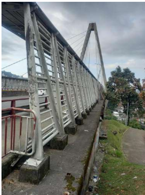
Fotografía No 12: estado barandas viaducto
