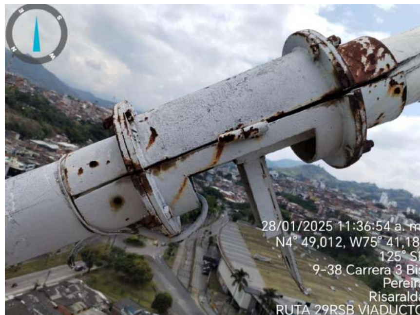
Fotografía No 21: estado de los herrajes de coberturas de los torones tirantes, con oxidación, posible corrosión y pérdida de algunos pernos en bridas de coberturas
