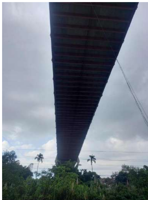
Fotografía No 9: vista inferior de la estructura metálica del viaducto, donde se observa una leve curvatura en planta.
