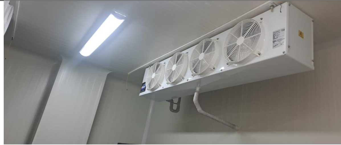
VENTILADOR CUARTO EQUIPO DE REFRIGERACION
