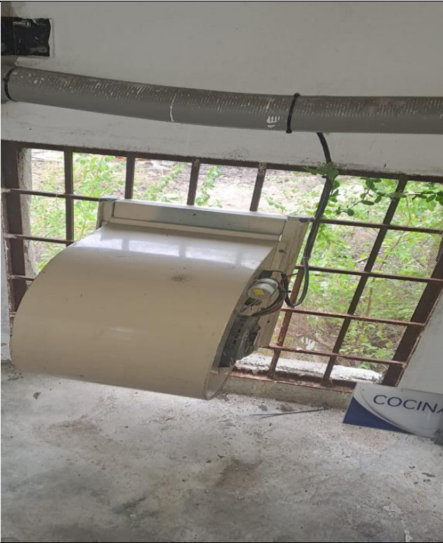
EXTRACTOR CUARTO PLANTA DE EMERGENCIA
