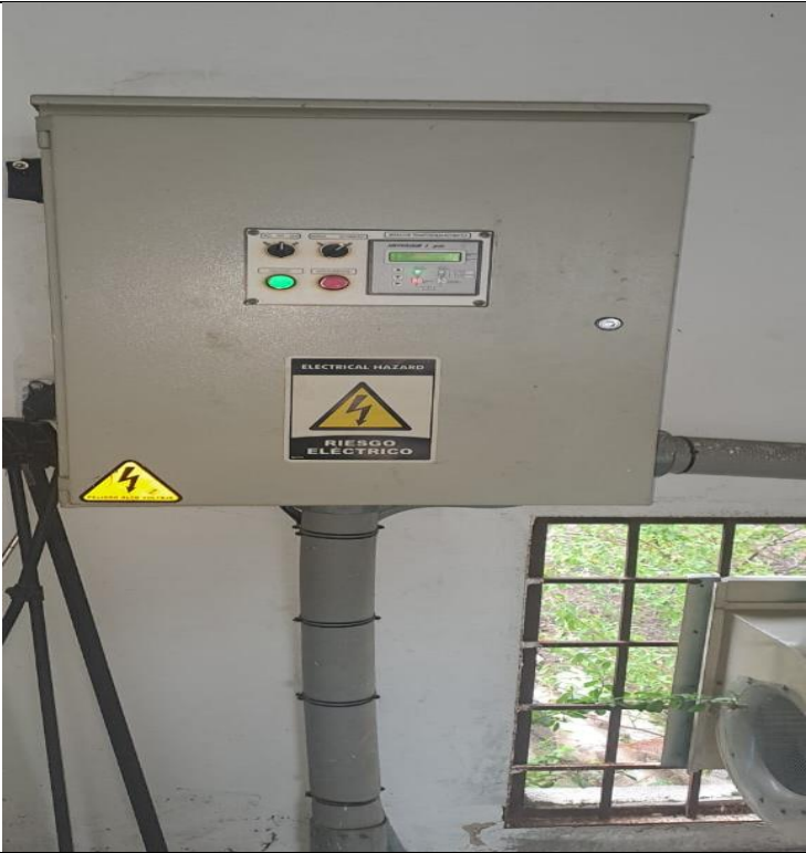
TRANSFERENCIA AUTOMATICA DE ENERGIA DE PLANTA DE EMERGENCIA Y RED EXTERNA
