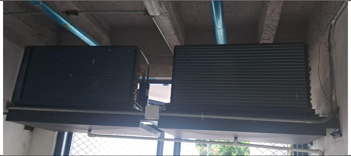
CONDENSADORAS DE SISTEMA DE EQUIPO DE REFRIGERACION
