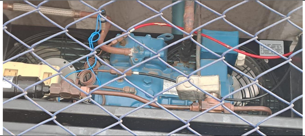
COMPRESOR 1 DE EQUIPO DE REFRIGERACION
