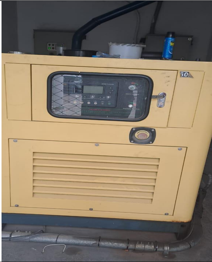
PLANTA DE EMERGENCIA
