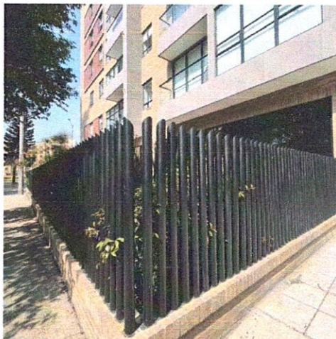
Ilustración 21 cerramiento perimetral plazoleta en tubo galvanizado
