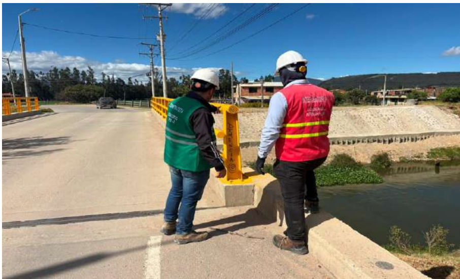
Imagen 3. BARANDAS VANDALIZADAS - MARGEN IZQUIERDO
