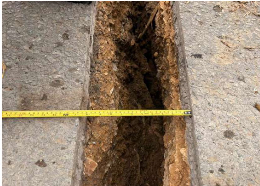
Imagen 2. VERIFICACIÓN DE 28 CM - DILATACIÓN DEL ESTRIBO
