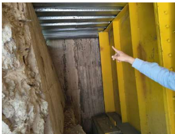
Fotografía 2: Interferencia del estribo con la viga fusible.
