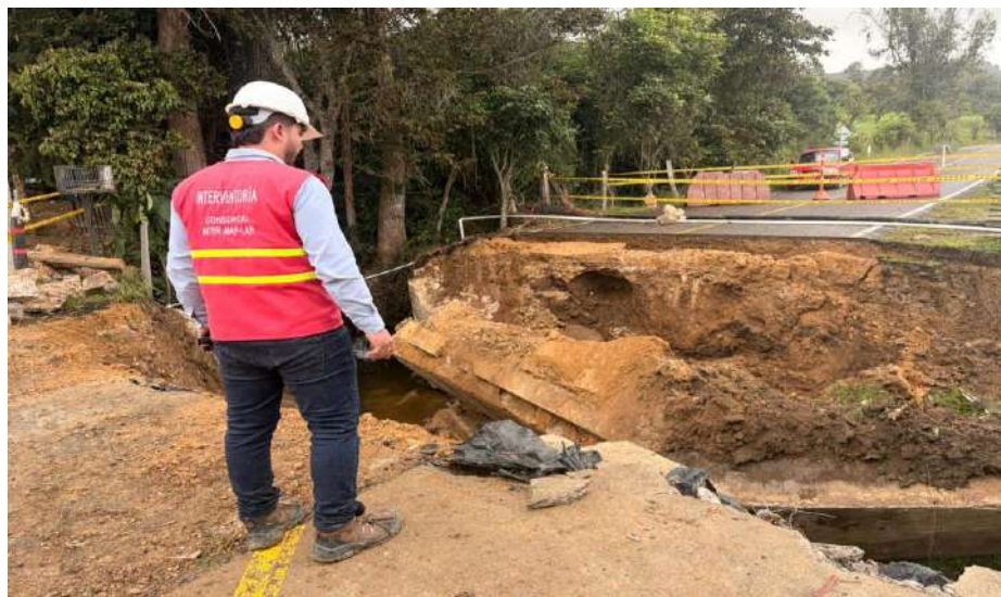
Imagen 3. COLAPSO DEL ESTRIBO
