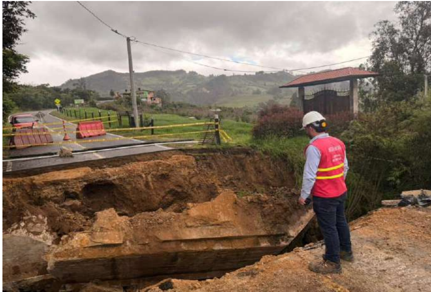
Imagen 4. COLAPSO DEL ESTRIBO
