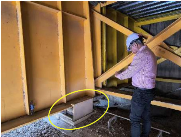
Fotografía 1: desplazamiento del patín
