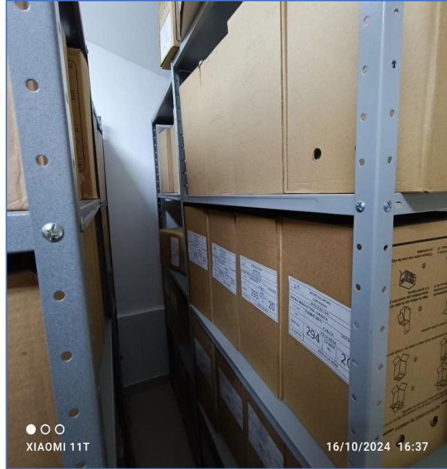
Fotografía 20 – Pasillos no cumple con espacio
