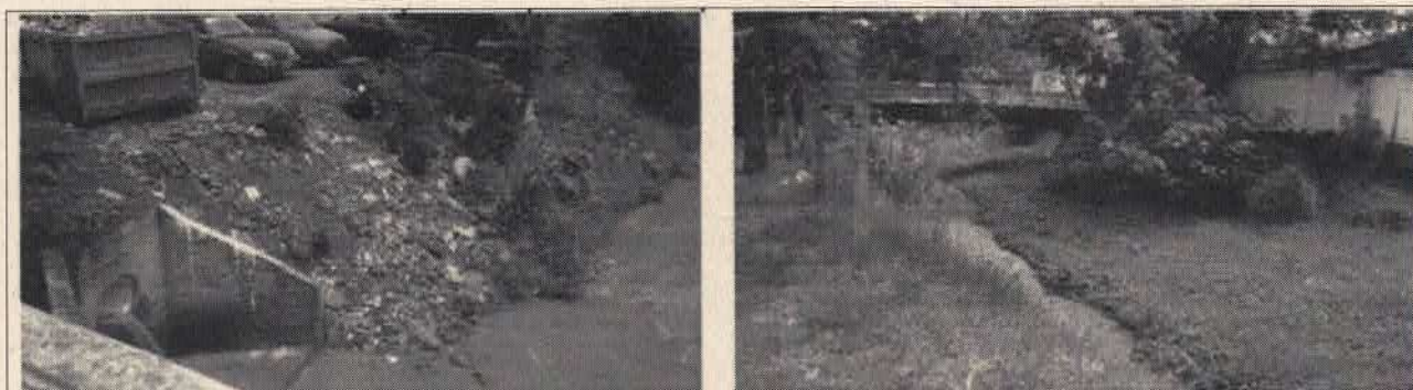
Imagen 4: Izq: Descargas de aguas residuales continuas sobre el Río Yumbo. Der: Reducción del cauce entre puente peatonal calle 8AN y puente vehicular calle 8N por vía y ocupación de cauce por galería.
