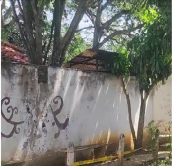
Descripción: Inclínación y fisura en muro de cerramiento por raíces de árbol cercano.
