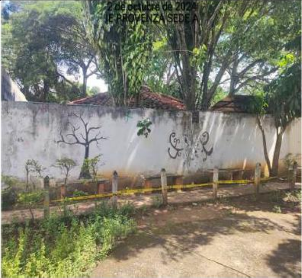
Descripción: Inclínación y fisura en muro de cerramiento por raíces de árbol cercano. Área de implementación de drenajes pluviales, bancas, espacios de instancia.
