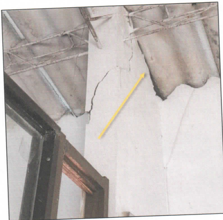
Ilustración 5. Lesión tipo 02 / agrietamiento y fisuramiento En muro interno de aula
