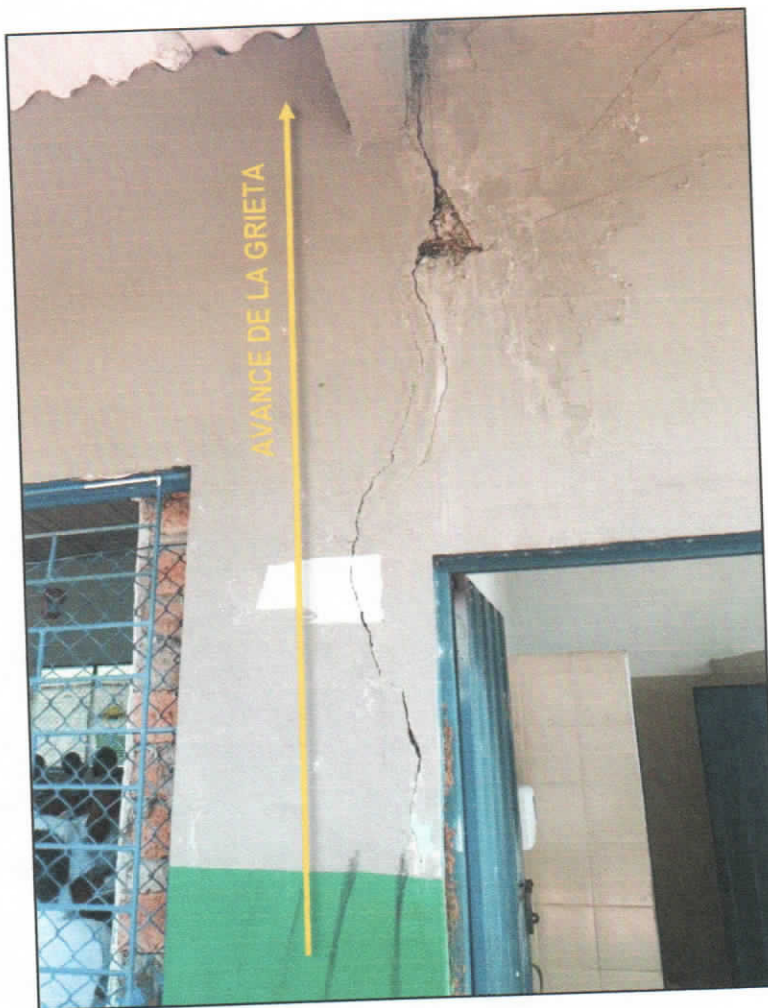
Ilustración 4. Lesión tipo 01 / agrietamiento y fisuramiento En muro localizado en baterías sanitarias
