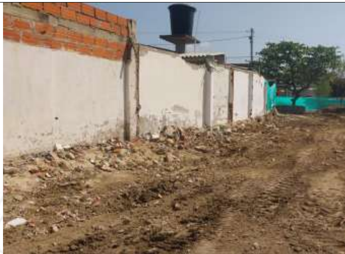
Fotografía 1: Muro con problemática.
