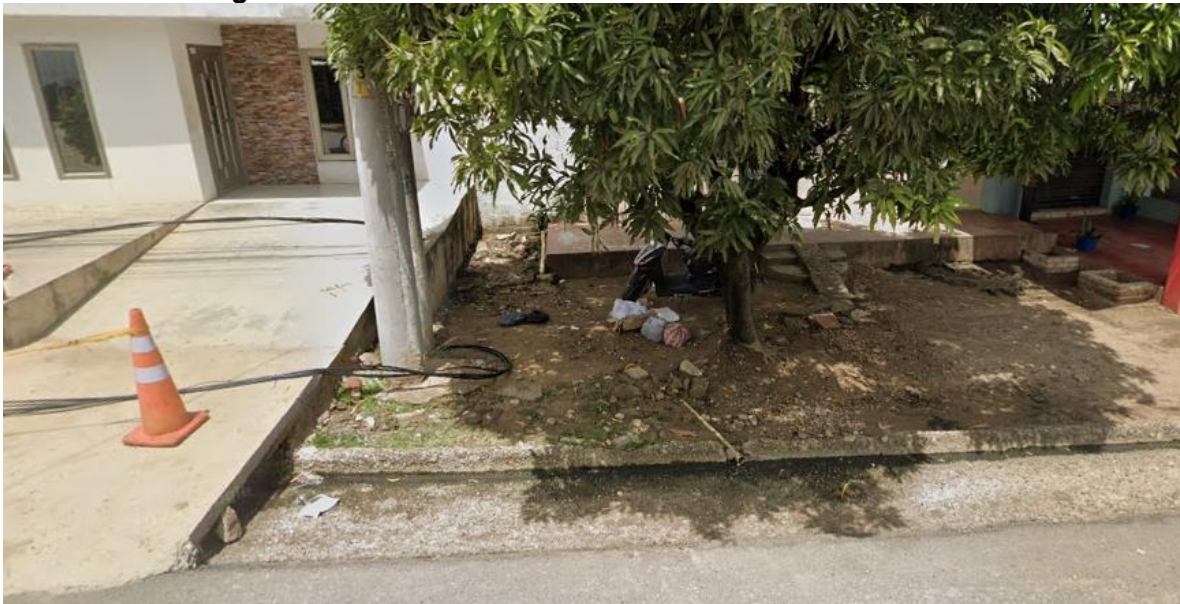
Figura 36. Cuneta abscisa K0+020 – K0+140 zona norte
