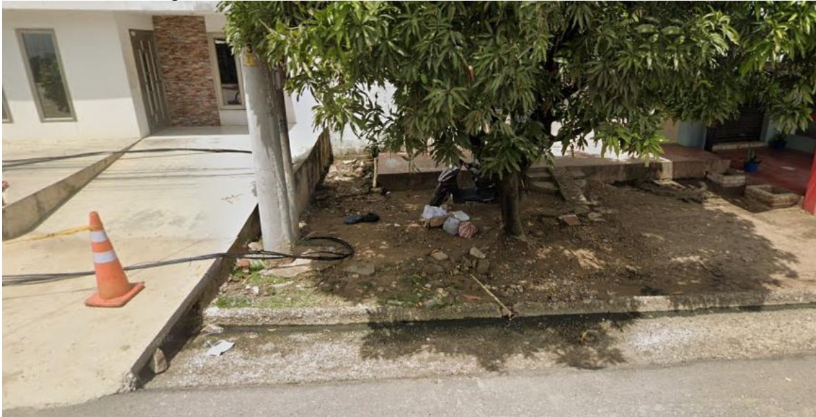
Figura 12. Cuneta abscisa K0+020 – K0+140 zona norte
