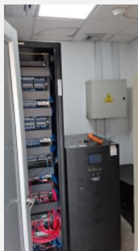
Figura 26. Cuarto técnico. Fuente: UT T&D Energy
