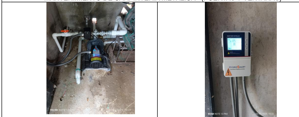
MANTENIMIENTO DE EQUIPO DE BOMBEO PREEMSAMBLADO cuarto de maquinas
