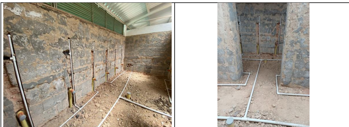
Instalaciones hidráulicas de acuerdo con las zonas y puntos establecidos en los planos.
