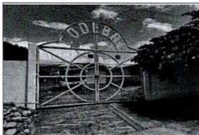
Ilustración 3. Estado actual del cerramiento perimetral CODEBAL
