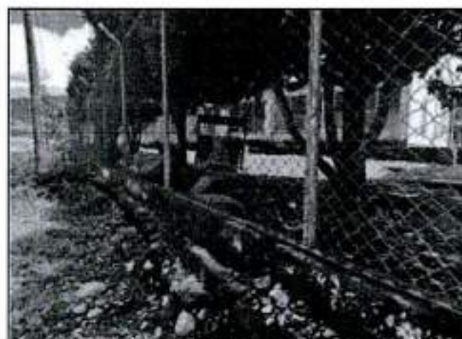
Ilustración 4. Estado actual del cerramiento perimetral CODEBAL
