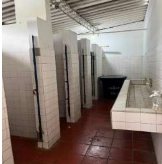
Canal defectuosa Fuente: Elaboración propia
