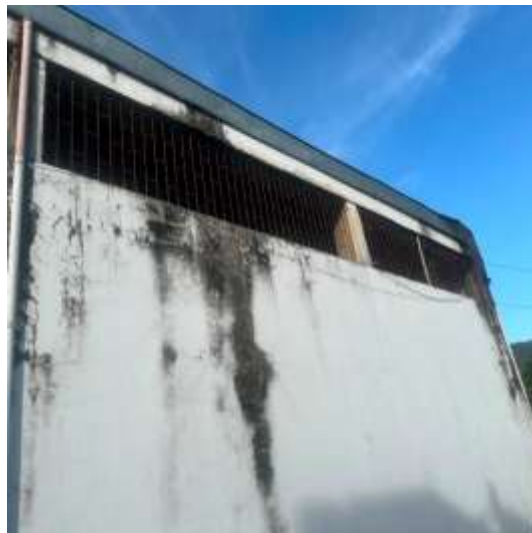
Canal defectuosa Fuente: Elaboración propia
