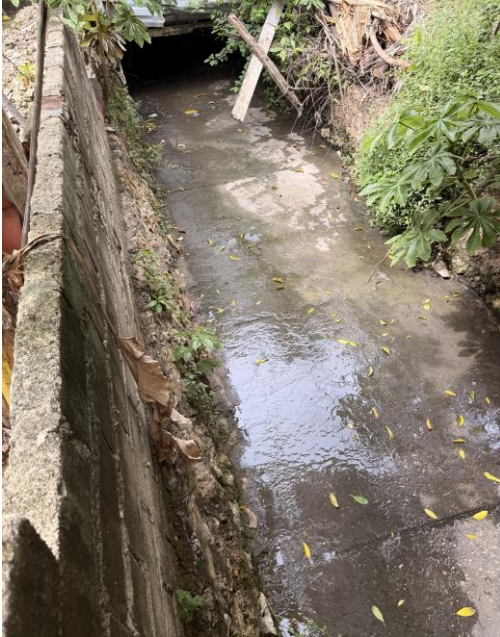
El Carmen – Fotografía 1. Canal abierto con agua/humedad y vegetación.
