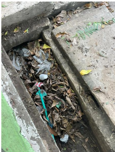
Fotografía Candelaria I – Parque de la Prosperidad. 1. Vista de cámara/canal con acumulación de hojas, residuos sólidos y material orgánico, evidenciando obstrucción de la sección de drenaje.
