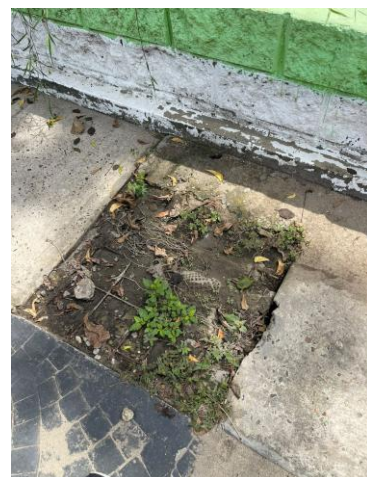
Fotografía Candelaria I – Parque de la Prosperidad. 5. Detalle de cámara con material orgánico y residuos sólidos, evidenciando la necesidad de limpieza y mantenimiento.
