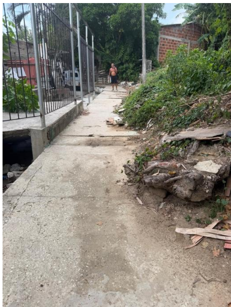
San Martín – Fotografía 1. Tramo con deterioro de cobertura y superficie de circulación.
