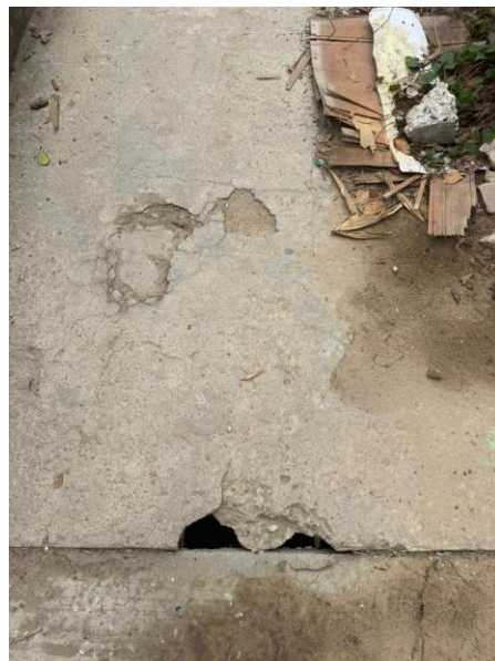
San Martín – Fotografía 2. Fractura y pérdida de material en elemento de concreto.
