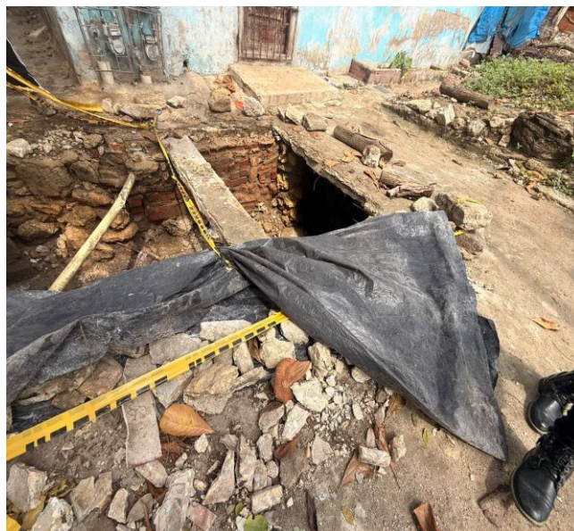
Los Almendros – Fotografía 2. Colapso de cobertura y aislamiento provisional.
