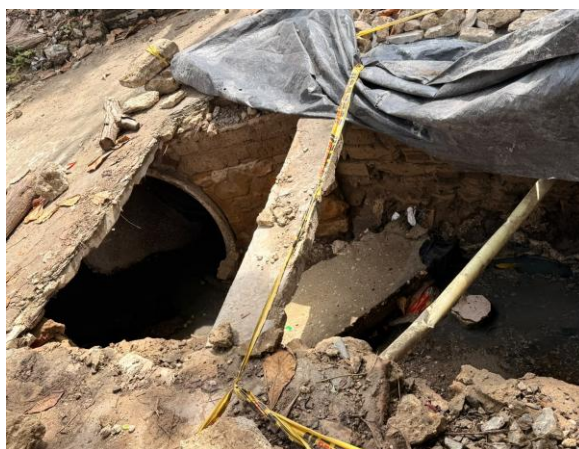
Los Almendros – Fotografía 4. Cavidad abierta y deterioro de soporte/cobertura.
