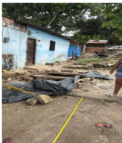
Los Almendros – Fotografía 3. Pérdida de continuidad de la cobertura.
