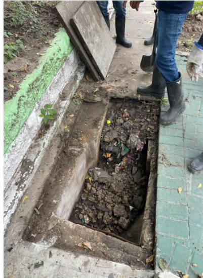
Fotografía Candelaria I – Parque de la Prosperidad. 7. Segundo registro del punto deteriorado, mostrando la pérdida de continuidad entre la superficie peatonal y la estructura.
