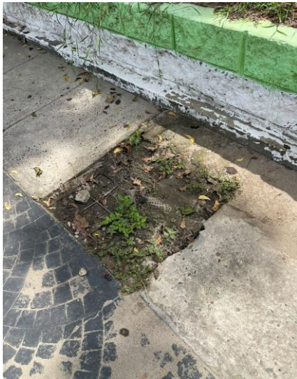
Fotografía Candelaria I – Parque de la Prosperidad. 6. Sector con deterioro de la superficie y presencia de vegetación en el área próxima al sistema de drenaje.
