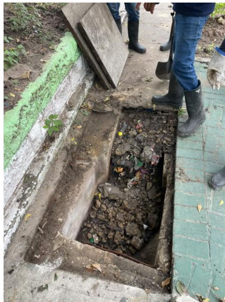
Fotografía Candelaria I – Parque de la Prosperidad. 2. Elemento de cobertura retirado durante la inspección y cavidad abierta con acumulación de residuos y material pétreo.
