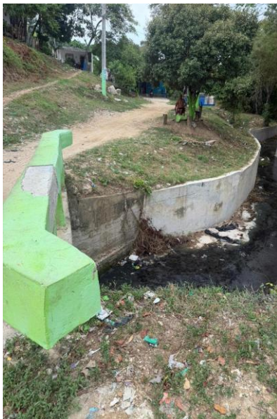
San Martín – Fotografía 4. Deterioro de superficie y elementos asociados.
