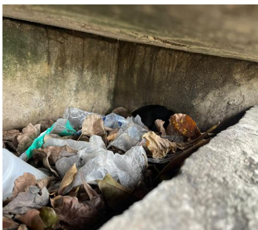
Fotografía Candelaria I – Parque de la Prosperidad. 3. Detalle del interior de la estructura con presencia de residuos, hojas y material acumulado en proximidad de la sección hidráulica.
