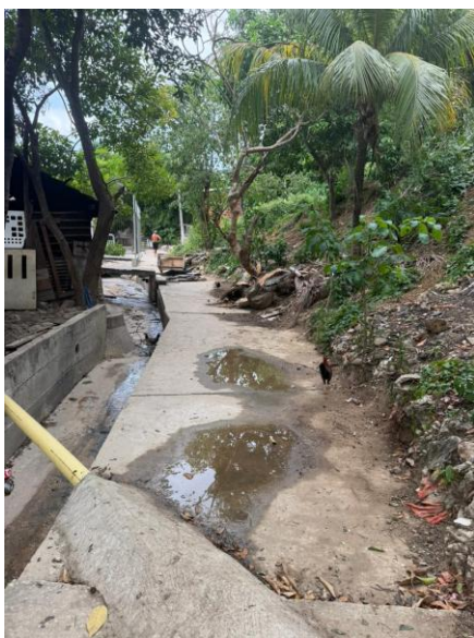
San Martín – Fotografía 6. Cobertura improvisada y abertura expuesta.
