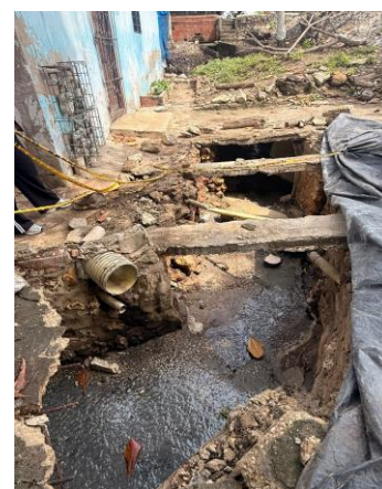
Los Almendros – Fotografía 5. Aberturas, agua, residuos y deterioro del tramo.
