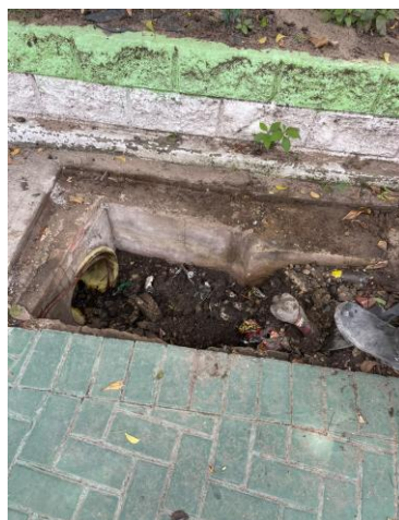
Fotografía Candelaria I – Parque de la Prosperidad. 4. Tramo de drenaje superficial con acumulación de sedimentos y residuos, asociado a una superficie de circulación peatonal.
