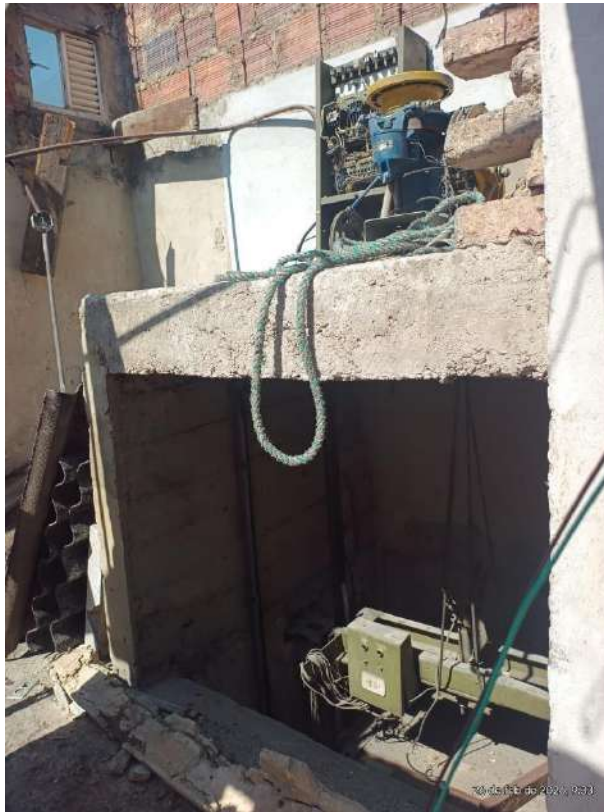
MOTOR Y CABINA DE ASCENSOR
