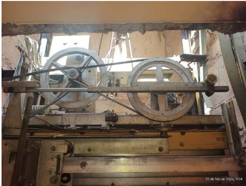
MAQUINAS Y POLEAS SOBRE CABINA
