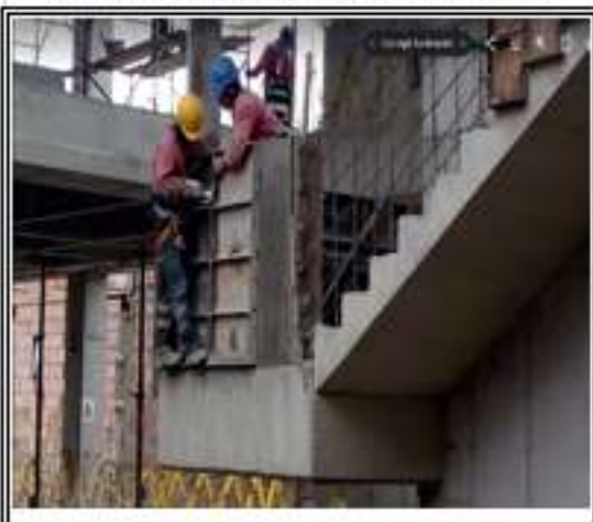
Foto No27 : antepecho cubierta conexión 2-3
