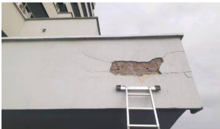
DESPRENDIMIENTO DEL MATERIAL
