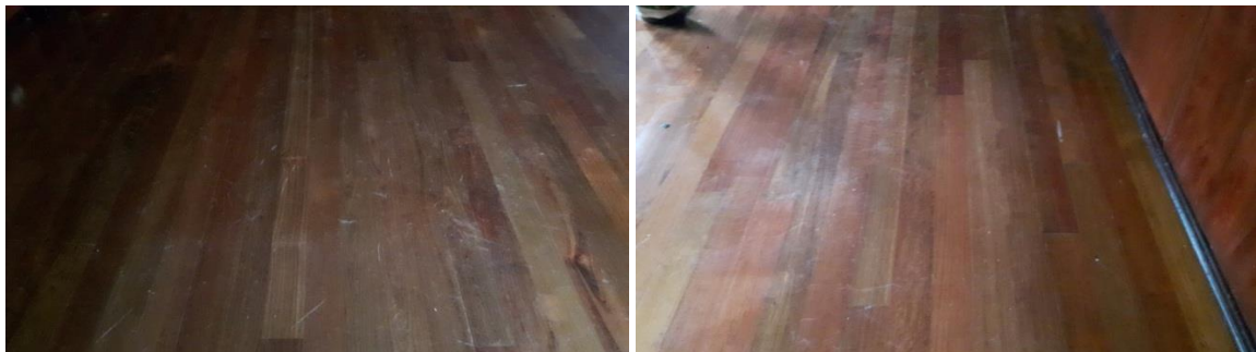
Fotografía 2 Estado Inicial del piso Salón 2 salón principal
