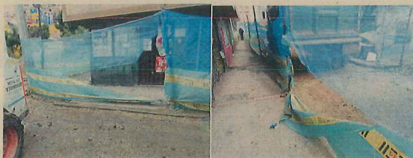
Cerramientos en mal Estado
