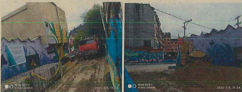
Acopios de material sin señalizar y demarcar y en el Sendero peatonal del PAC
