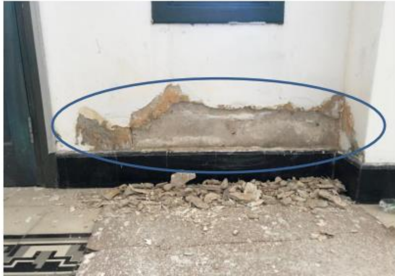
Imagen 5 y 6. Desprendimiento de pañete, estuco y pintura en fachada de la antigua INTENDENCIA FLUVIAL
