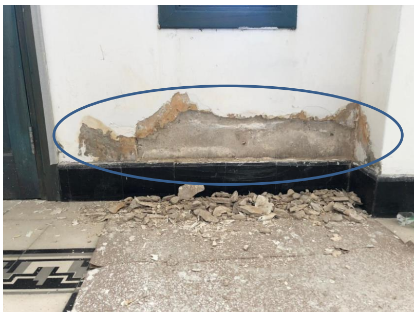
Imagen 5 y 6. Desprendimiento de pañete, estuco y pintura en fachada de la antigua INTENDENCIA FLUVIAL
