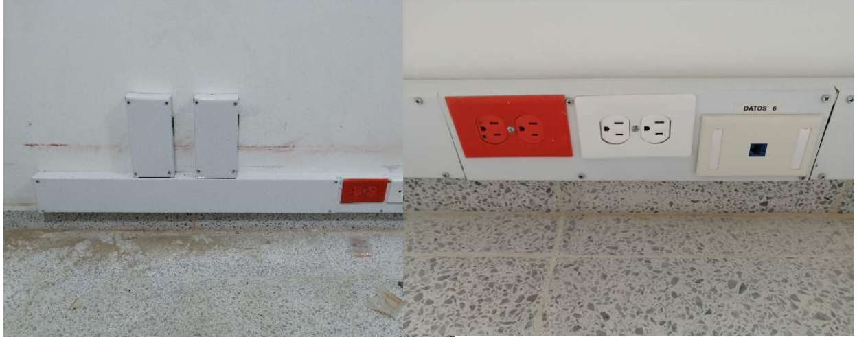
Salidas Eléctricas Voz Y Datos.
