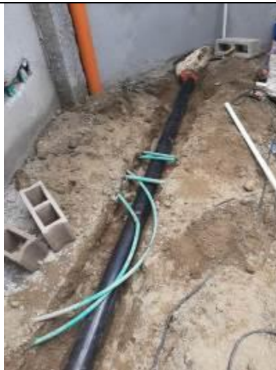
Tubería de SCH 40 de 4" Contraincendios enterrada.
