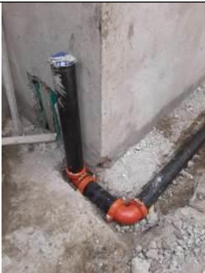
Tubería de SCH 40 de 4" Contraincendios enterrada.
