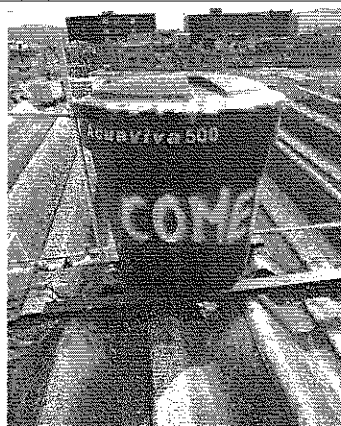
TANQUE DE AGUA
