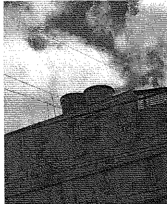
TANQUE DE AGUA
