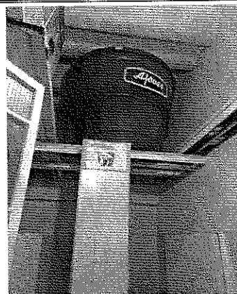
TANQUE DE AGUA
