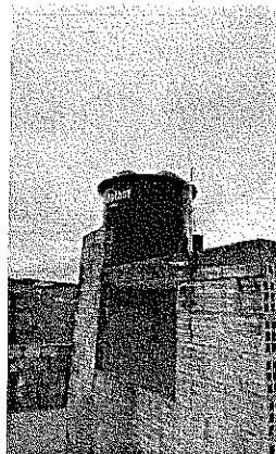
TANQUE DE AGUA
