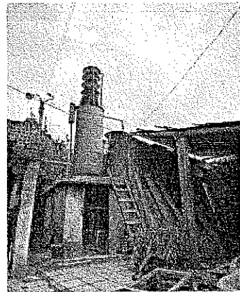
TANQUE DE AGUA
