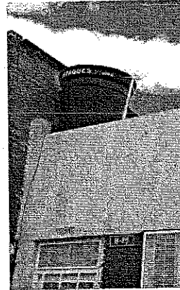
TANQUE DE AGUA
