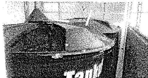
TANQUE DE AGUA
