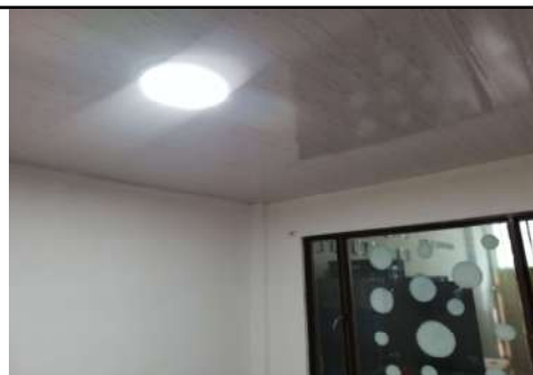
DESCRIPCION: CIELORRASO DE DESPENSA (SUBSANADO)
