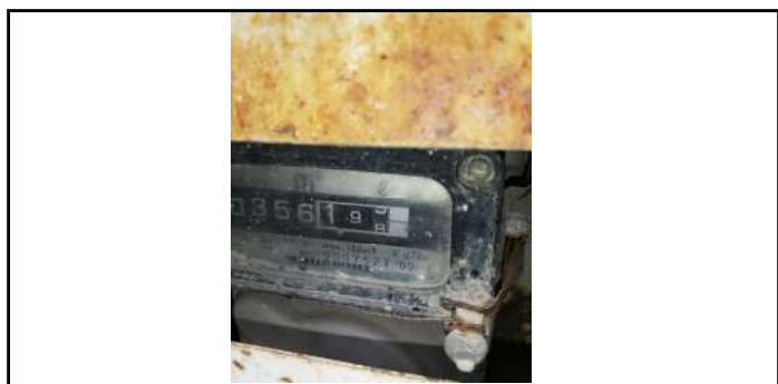
DESCRIPCION: CONTADOR DEL GAS
