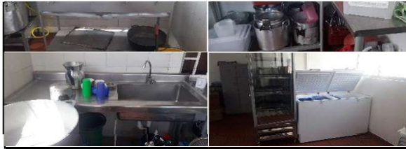
DESCRIPCION: EL AREA NO CUMPLE Y NO SON ADECUADAS
