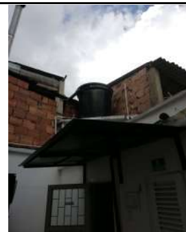
DESCRIPCION: TANQUES DE RESERVA
