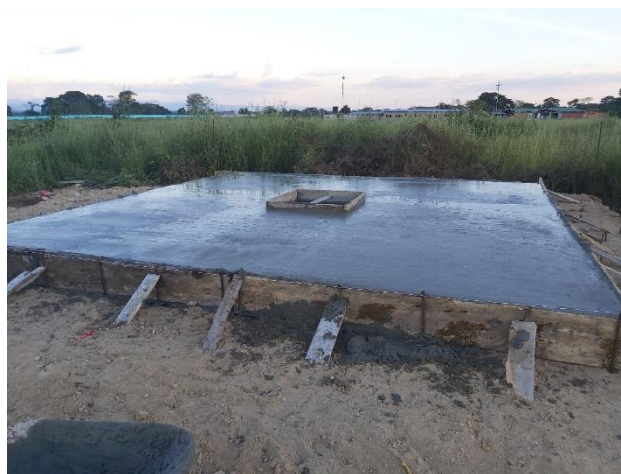
Imagen 15. Placa torre grúa No. 5
