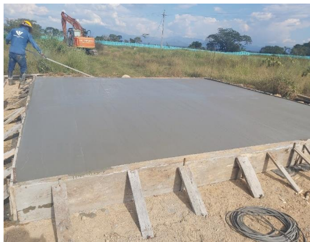
Imagen 14. Placa torre grúa No. 4
