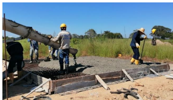
Imagen 12. Placa torre grúa N. 7
