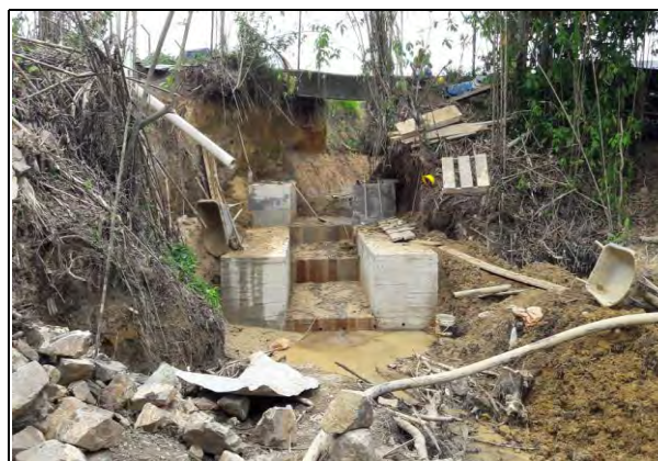
FOTO 6: RECUBRIMIENTO DE GAVIONES EN CONCRETO - DETALLE ZONA IMPACTADA POR EXCAVACIÓN
