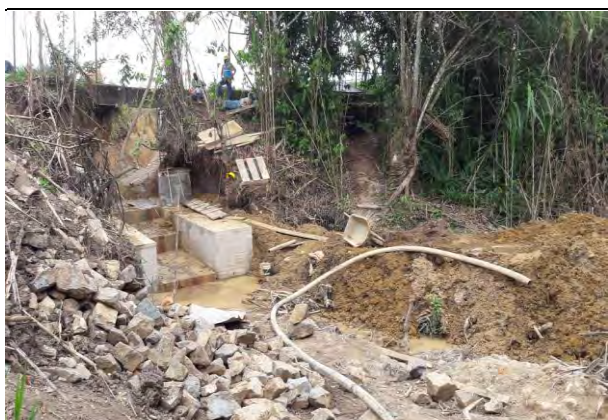
FOTO 5: RECUBRIMIENTO DE GAVIONES ESTRUCTURA DE DESCOLE - SE APRECIA ZONA IMPACTADA POR EXCAVACION
