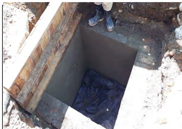
FOTO 6: TERMINACION CAJA DE INSPECCION ALCANTARILLADO - FALTAN FUNDIR TAPAS
