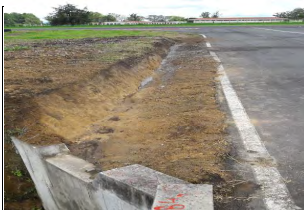
FOTO 12: CUNETAS CALLE DE BOMBEROS
