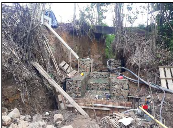
FOTO 4: DETALLE TERMINACION ESTRUCTURA DESCOLE EN GAVIONES, SE DEBE DE COMPENSAR ZONA INTERVENIDAD POR EXCAVACIONES
